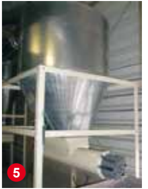
TRASH COMPACTORS COMPACTADORES DE DESPERDICIO
